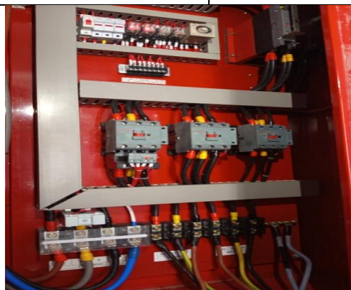
Gambar 4. Panel Utama Elektrik fire pump
